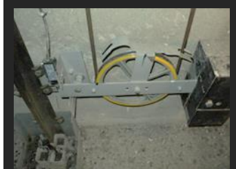
Polea en fondo de foso (PIT) de un regulador de velocidad de elevador con cuarto de máquinas, Año: 2010
